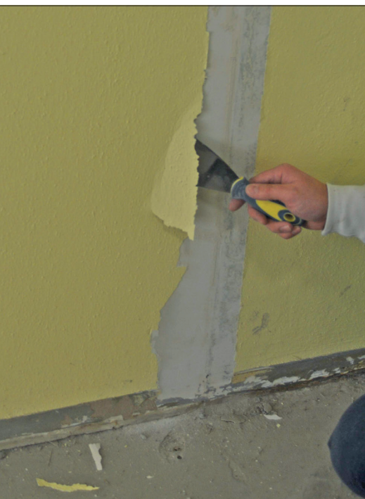
Alte Tapeten entfernen: Risiko asbesthaltige Spachtelmasse oder Innenputz (Foto: Rolof)
