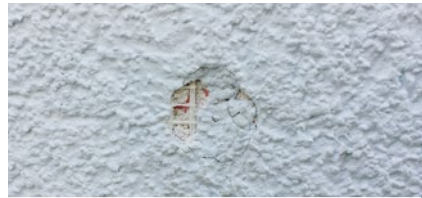
Mechanischer Schaden in der Fassade
