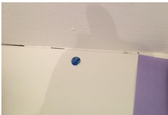
Bild 4: Unsauberes Anschlussbild nach Beschichtung eines Trennschnitts zwischen Decke und Wand
