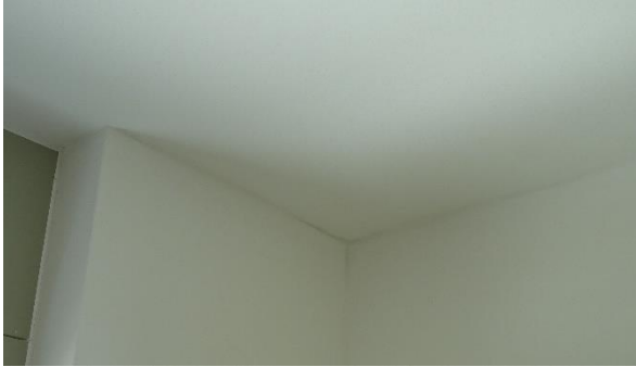
Bild 7: Dunklere Abzeichnung des überarbeiteten Dichtstoffs
