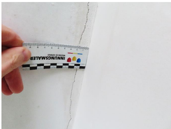
Bild 2: Unkontrollierter Abriss zwischen einer Trockenbauwand und einer geputzten Wand infolge eines fehlenden Trennschnitts
